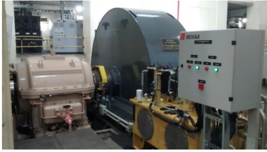
a) Hydraulic Power Unit (HPU)
