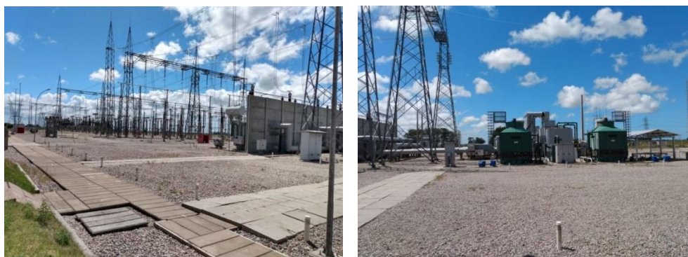
Figura 05 – Vista geral da SE Marmeleiro 2.
