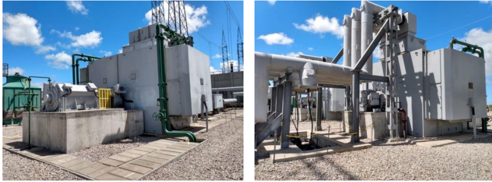
Figura 08 – Visão geral de um dos compensadores da SE Marmeleiro 2.
