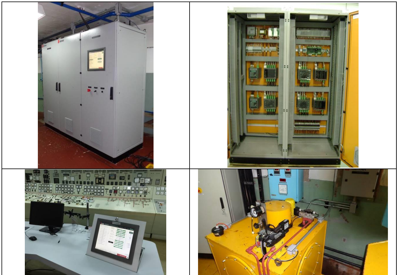
Figura 2 – Visão geral do hardware instalado
