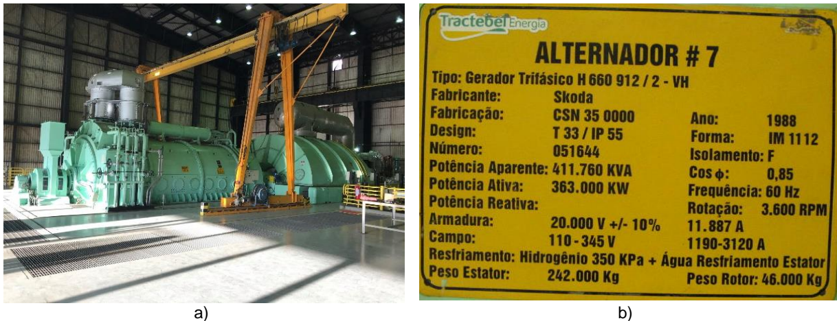
Figura 4: UG07 de Jorge Lacerda. a) Vista geral da turbina e gerador; b) Dados de Placa do Gerador da UG07.
