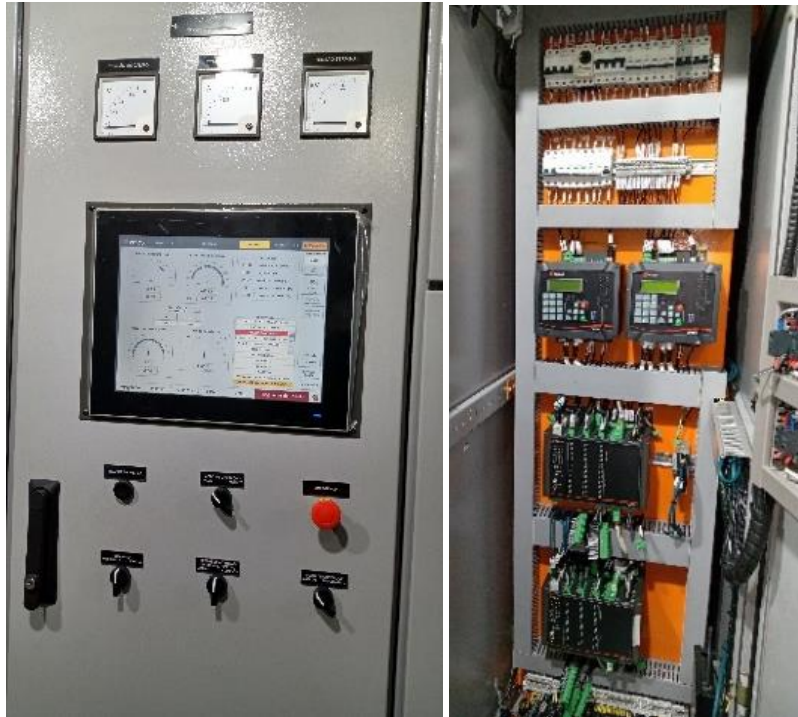
Figura 9: Cubículo de controle do RTX POWER.
